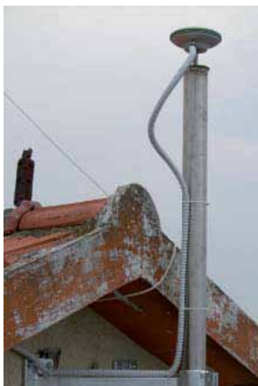
Рис.2 Пример установки антенны спутникового приемника базовой станции на высокой мачте
